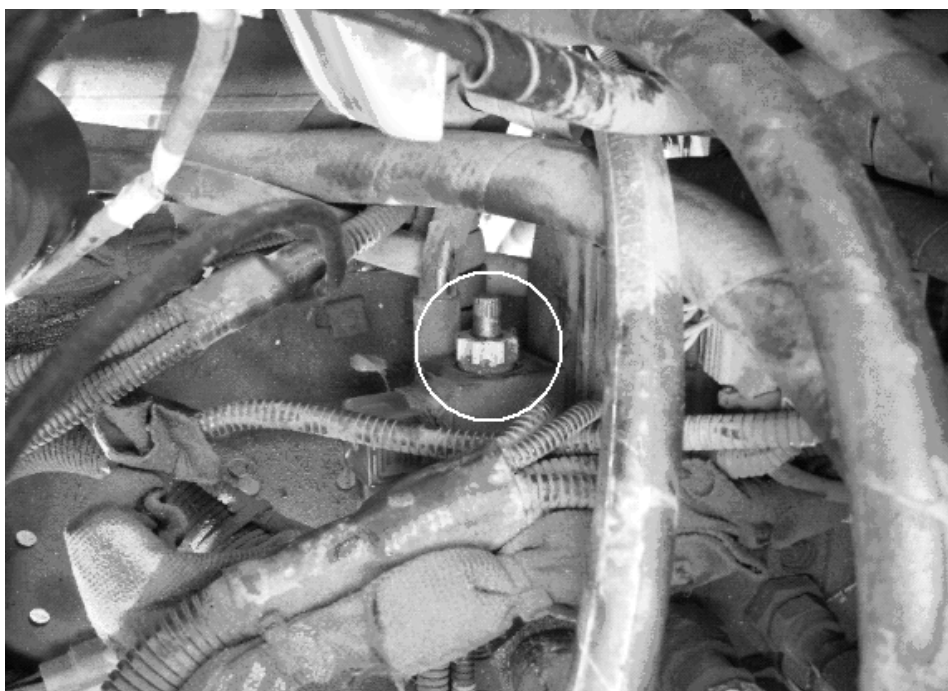
Rys. 12.11 Przycisk elektrozaworu wyłącznika awaryjnego (zaznaczony kółkiem)
